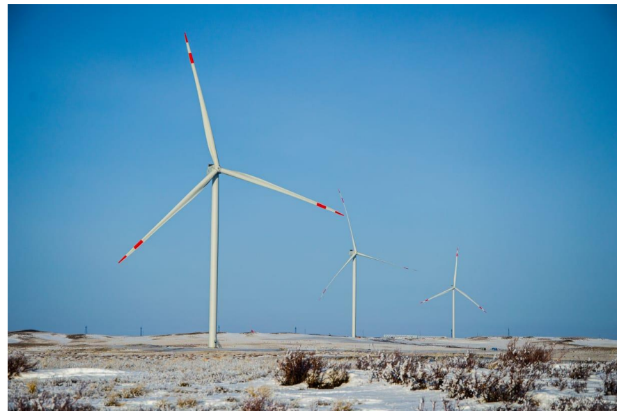
ВЭС Бадамша-2 мощностью 48 МВт
