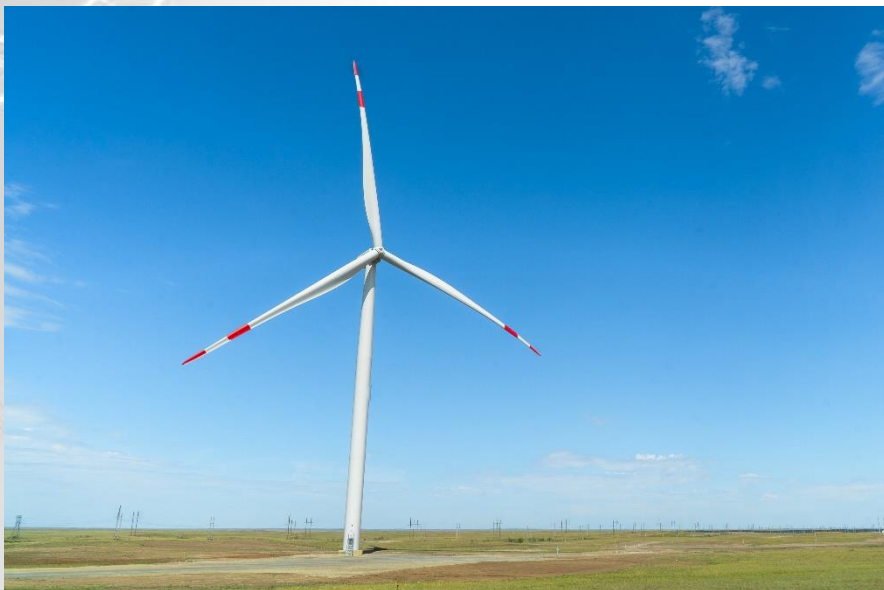
ВЭС Бадамша-1 мощностью 48 МВт
